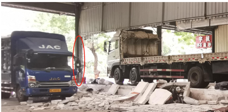
图 3、型钢立柱与墙体间无连接稳固措施
