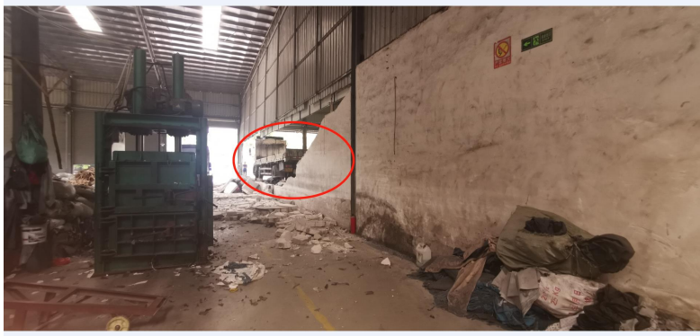
图 2、发生坍塌的西段墙体
