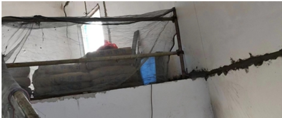
图3 靠墙放置袋装水泥情况
